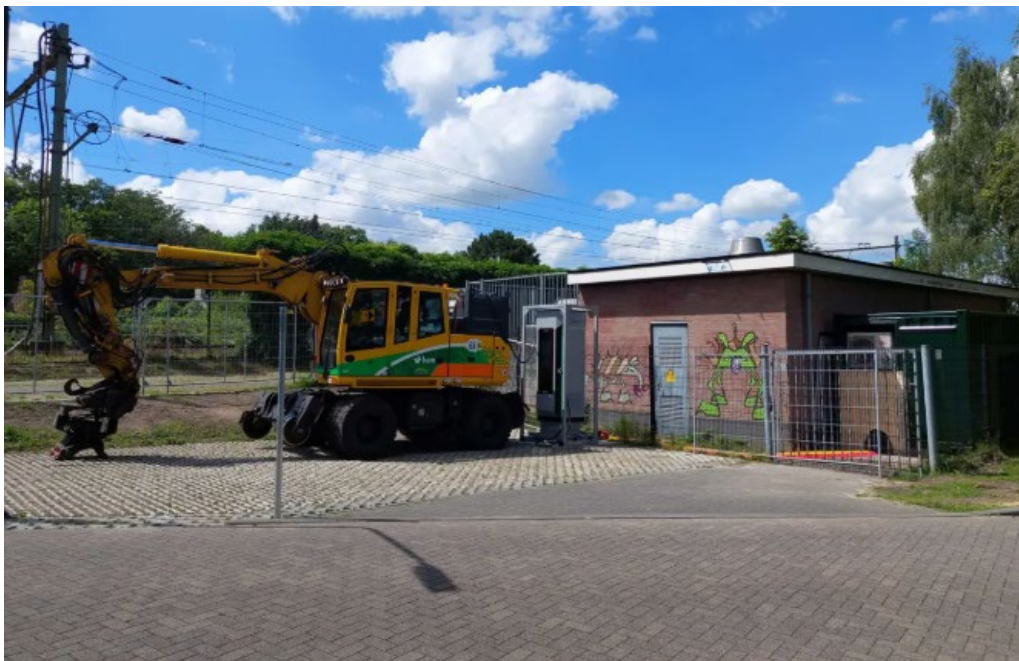
Figuur 6.1: Laden bij het onderstation in Vught: Bron: ProRail: Primeur in Vught | ProRail .
