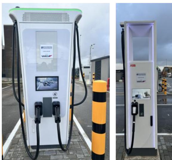
Figuur 3.26: ABB laders met kabelbeheersysteem bij TRE.
