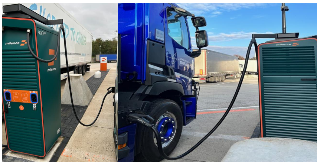
Figuur 3.31: Alpitronic lader met kabelbeheersysteem bij Milence laadplein.
