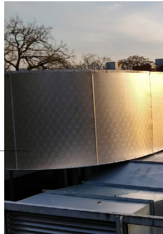
Foto 3: SchoolVent luchtbehandelingskast met geïsoleerde lichtkanalen.
