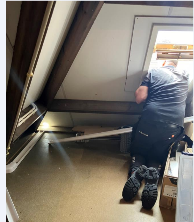
Monteur communiceert met een collega die bij buitenunit staat.
