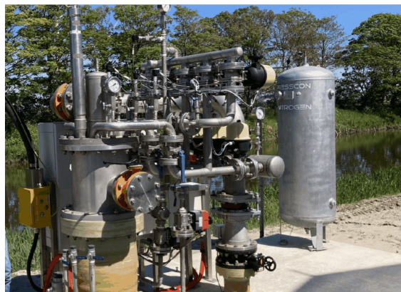
Figuur 22: Pompinstallatie voor de HTO demo in Middenmeer (bron: IF Technology)
