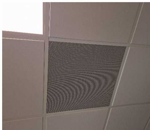
Figuur 4.8 Voorbeeld van afvoerrooster in de ruimte
