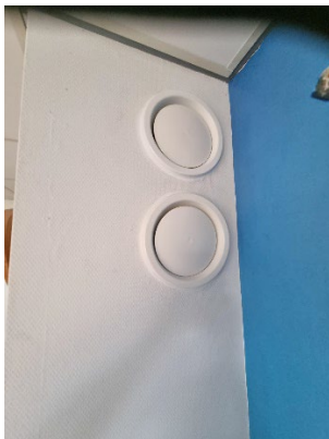
Figuur 6.8: 2 afvoerrozetten in de ruimte
