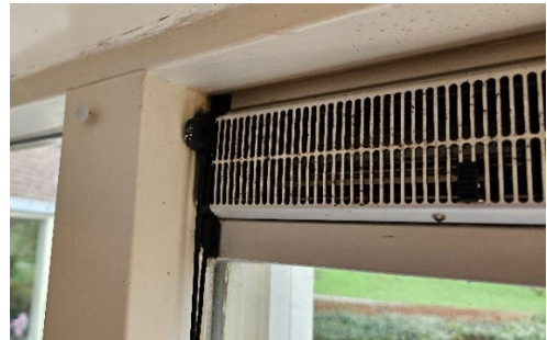
Figuur 8.8 Ventilatierooster met zichtbare verontreiniging
