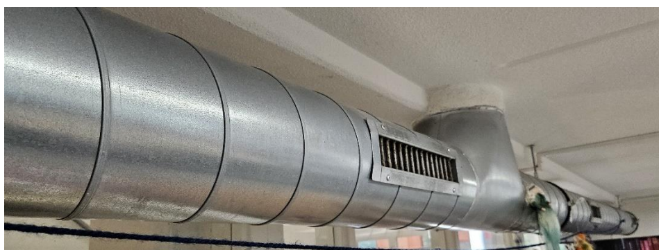
Figuur 10.9 Kanaal onder plafond, voorzien van afvoerroosters met mechanische afvoer.
