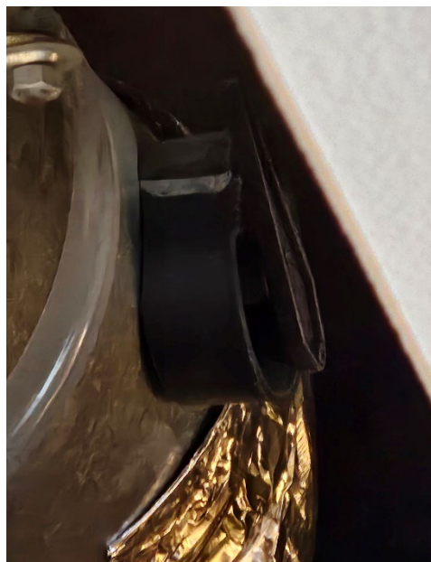
Figuur 3.8 Close-up van de regelklep van het toevoerluchtkanaal
