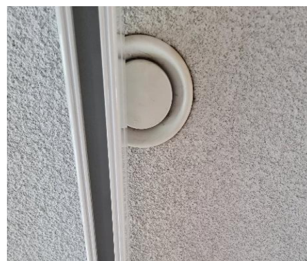
Figuur 6.4: Voorbeeld van afvoerpunt in ruimte 1
