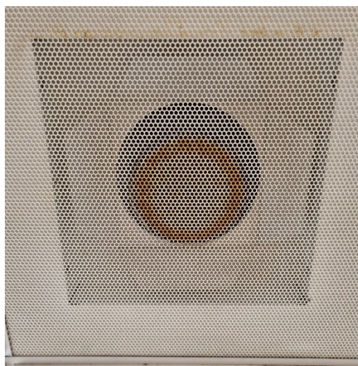
Figuur 8.3: Voorbeeld van toevoyerrooster in ruimte 1
