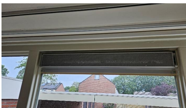
Figuur 7.8: Sterk vervuild ventilatierooster.
