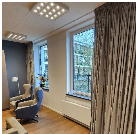
Figuur 4.3 Een ClimaRad-systeem geplaatst onder een te openen klapraam
