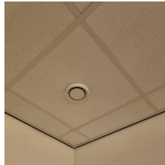
Figuur 4.7: Voorbeeld van één afvoerrooster in de ruimte
