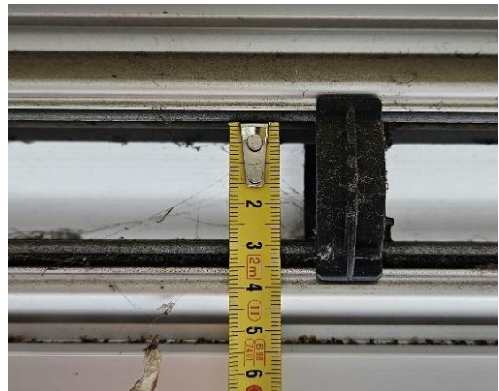
Figuur 2.2: Opmeten netto doorlaat ventilatioerooster.
