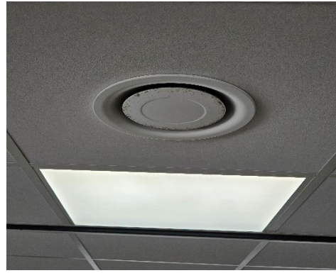
Figuur 5.12 Voorbeeld van afvoerroosters in de ruimte
