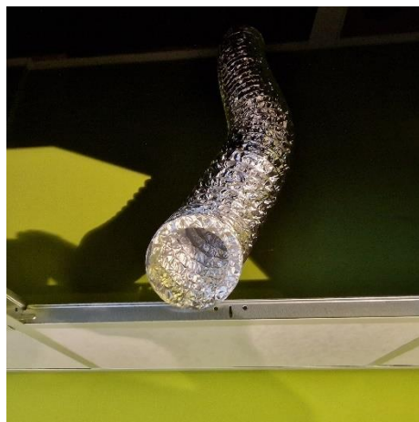
Figuur 12.4 Toevoerslang in plenum, zichtbaar door verwijderen plafondplaat
