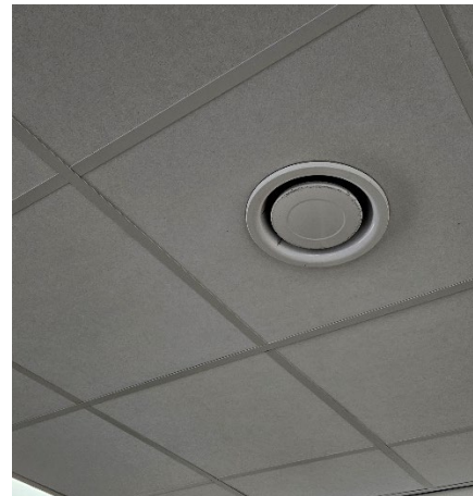
Figuur 5.8 Voorbeeld van afvoerrooster in de ruimte
