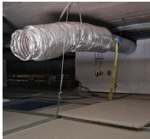
Figuur 6.3 Foto van een flexibele afvoerslang gehangen in het plenum
