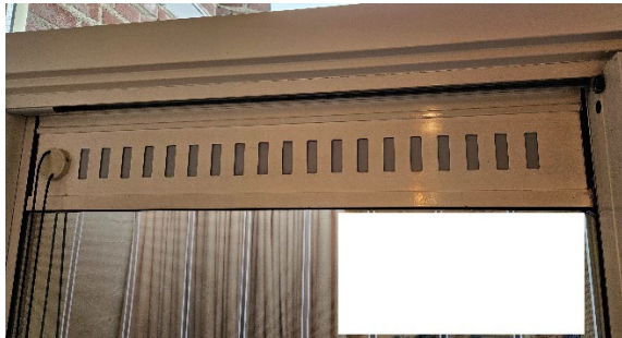
Figuur 8.7 Het ventilatierooster permanent dichtgezet.
