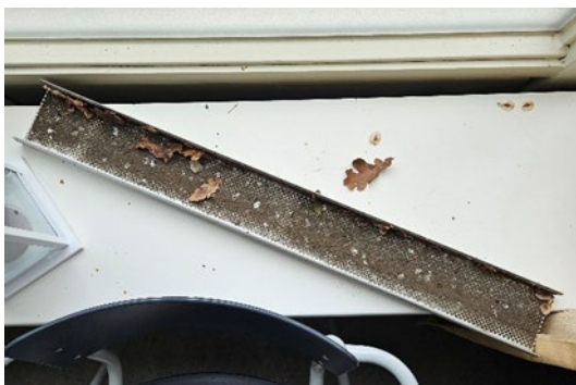
Figuur 3.4 : vervuilde binnenzijde toevoerrooster
