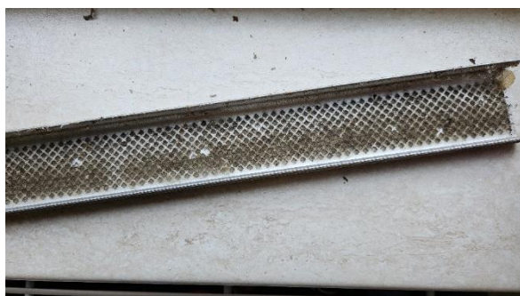
Figuur 9.3: Kap van ventilatierooster, binnenzijde is vervuild.
