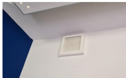
Figuur 3.12: Voorbeeld van een overstroomrooster (afvoer) in ruimte 3
