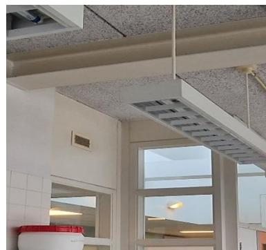
Figuur 5.8: Afvoerrooster in ruimte 2
