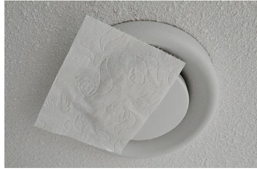
Figuur 3.7: werking mechanische afvoervoorziening controleren
