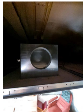
Figuur 5.8: Afvoerpunt boven het plenum van de ruimte (niet aangesloten)
