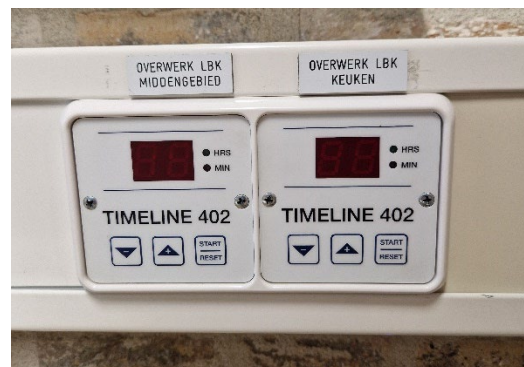
Figuur 5.4 De regelknoppen om de luchtbehandelingskasten in overwerkstand te zetten.
