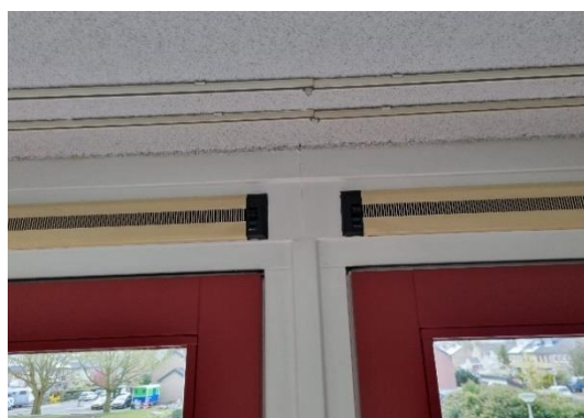
Figuur 6.3: Voorbeeld van toevoerrooster in ruimte 1
