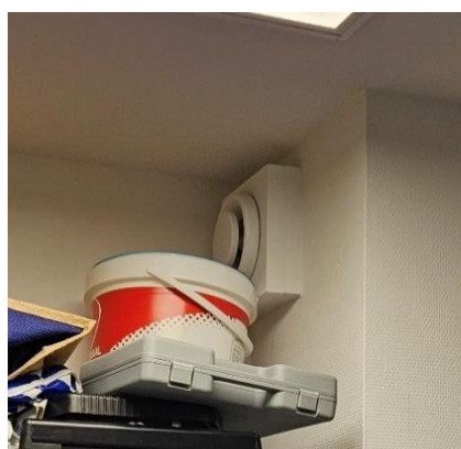
Figuur 5.6: Afvoerpunt in werkkast.
