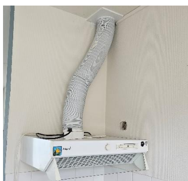
Figuur 7.7: Afvoerpunt in afzuigkap.
