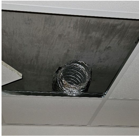
Figuur 3.11 De afvoerflexibel boven het plenum
