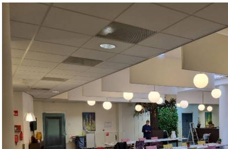
Figuur 4.3: Voorbeeld toe- en afvoerroosters in de ruimte
