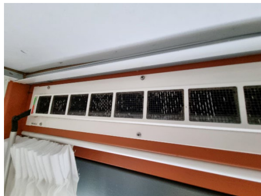
Figuur 6.7: voorbeeld van ventilatie raamrooster in de ruimte
