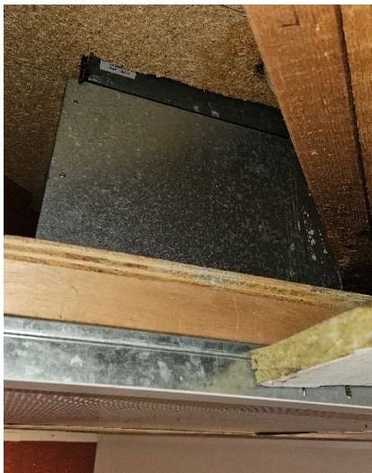
Figuur 8.3 Aanzicht van één van de mechanische afvoervoorzieningen in het plafond.
