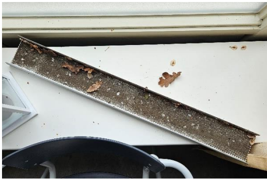
Figuur 7.3: Sterk vervuild ventilatierooster.
