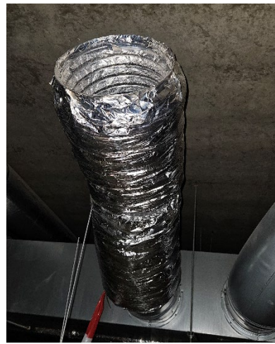
Figuur 9.4 Voorbeeld van één van de zes flexibele slangen in het plenum, verantwoordelijk voor de afvoer van lucht.
