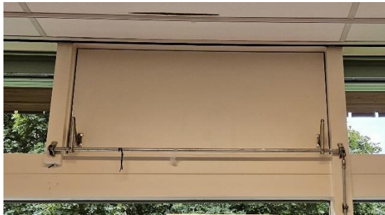
Figuur 6.3: Klepraam op 2,6m hoogte in kozijn.
