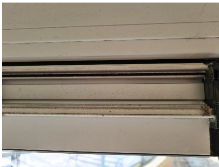
Figuur 5.11: ventilatierooster in de ruimte.
