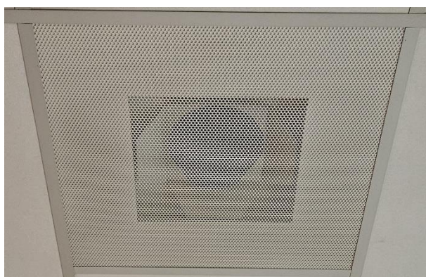
Figuur 6.6: Toevoerpunt in plenum (geen mechanische luchttoevoer gemeten).
