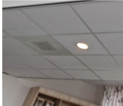
Figuur 4.8 Voorbeeld van afvoerrooster in de ruimte
