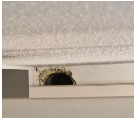
Figuur 3.3 Afvoergat in keukenwand. Aangesloten op ventilatiebox
