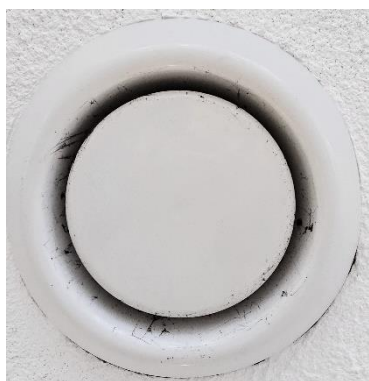
Figuur 10.6 Eén van de aanwezige afvoerozetten in het plafond.
