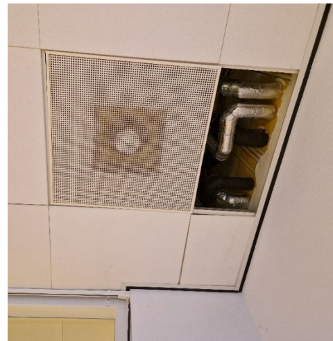
Figuur 5.8 Voorbeeld van een geperforeerd afvoerrooster in de ruimte en missende plafondtegel
