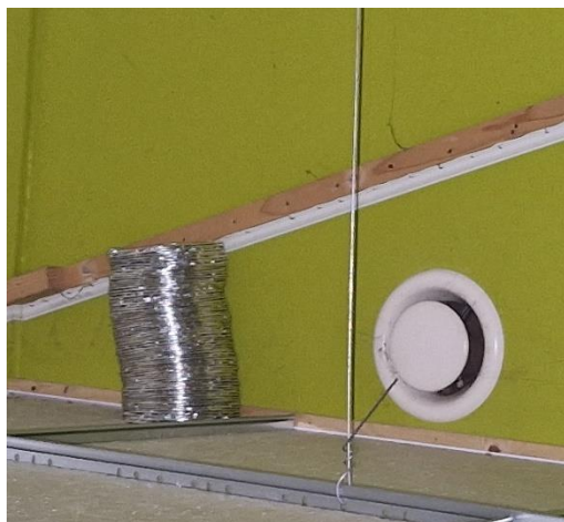
Figuur 12.3 Afvoerrozet in muur plenum met daarnaast losliggende flexibele slang
