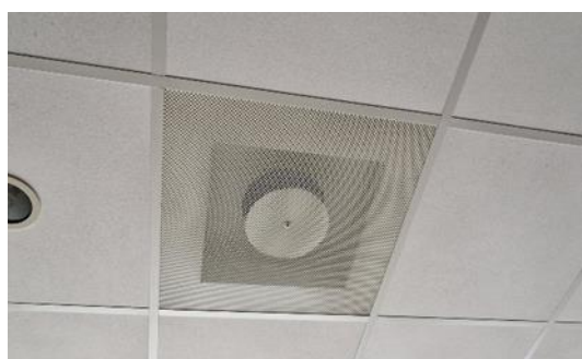
Figuur 4.13: Voorbeeld van toevoerrooster in ruimte 1
