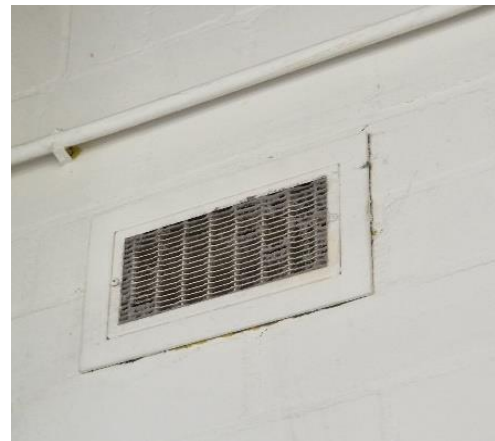
Figuur 5.12: Voorbeeld van het afvoerrooster ruimte 3
