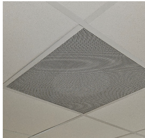
Figuur 3.12 Één van de twee toevoerroosters in de ruimte
