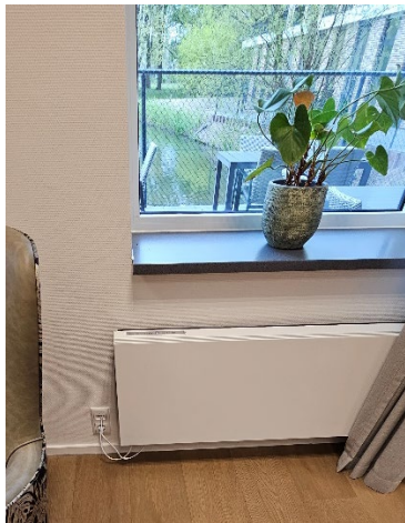
Figuur 4.7 Een ClimaRad-unit geplaatst onder een raam
