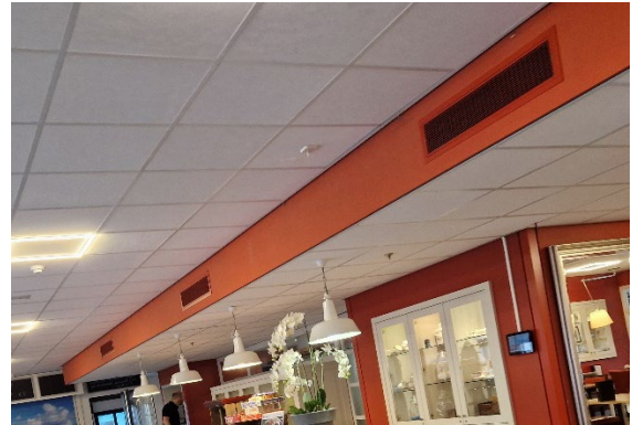
Figuur 3.12 Voorbeeld van afvoerroosters in de ruimte
