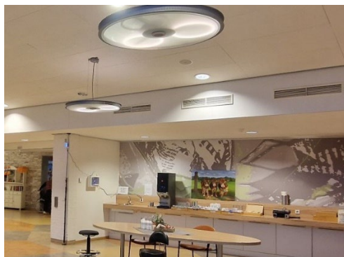
Figuur 5.3 3 van de 6 langwerpige toevoerroosters in de centrale ontmoetingsruimte
