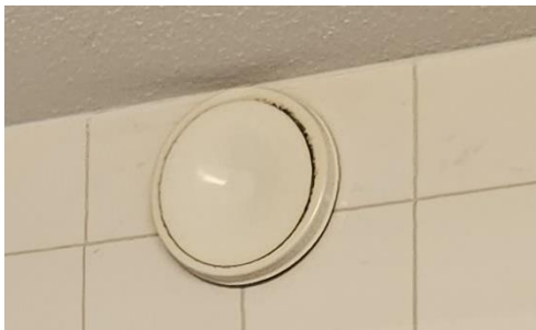
Figuur 4.3: Afvoerpunt in aangrenzende wasruimte.
