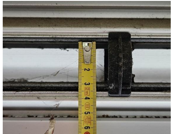
Figuur 2.2: Opmeten netto doorlaat ventilatioerooster.
