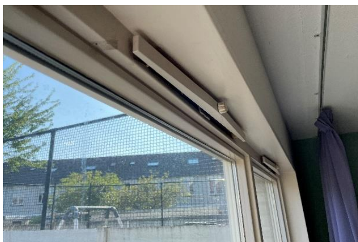
Figuur 4.28: Voorbeeld van een ventilatierooster in ruimte 1
