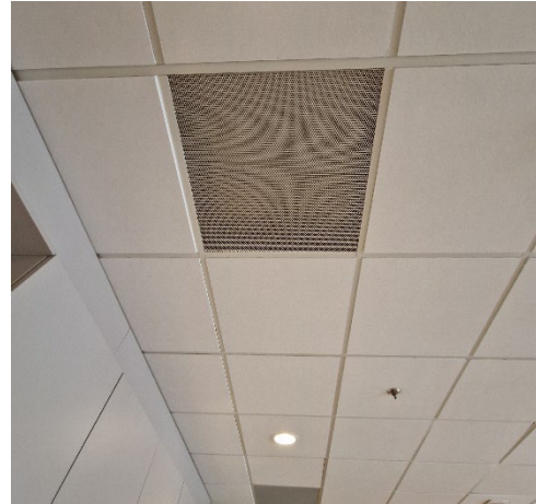
Figuur 3.8 Voorbeeld van afvoerrooster in de ruimte
