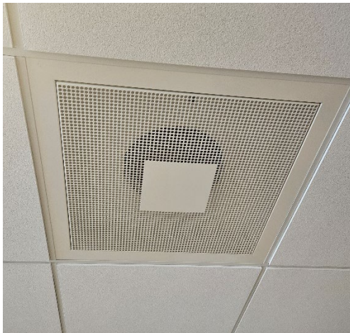
Figuur 3.3 Een van de twee toevoerroosters in de ruimte
