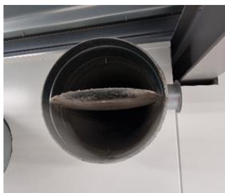
Figuur 5.20 Afvoerkanal met klep in ruimte 1
