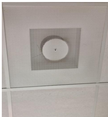
Figuur 4.25: Voorbeeld van toevoerrooster in ruimte 1
