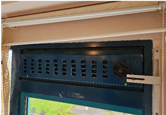
Figuur 10.11 Eén van de drie ventilatieroosters
