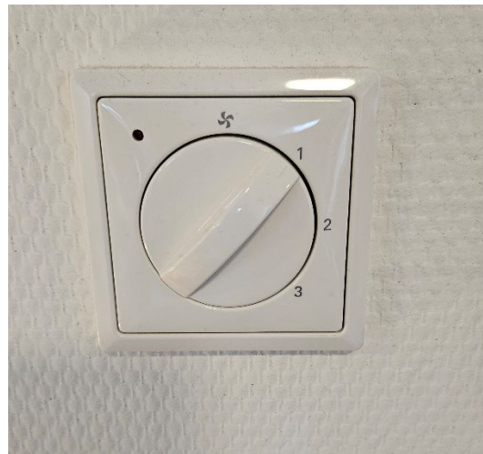
Figuur 7.8 De standenschakelaar voor de regeling van de ventilatie
