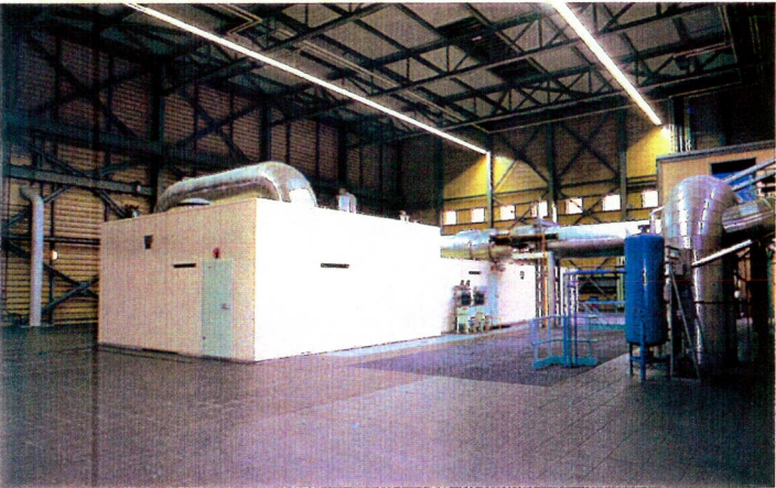
Machinehal met stoomturbine en generator
