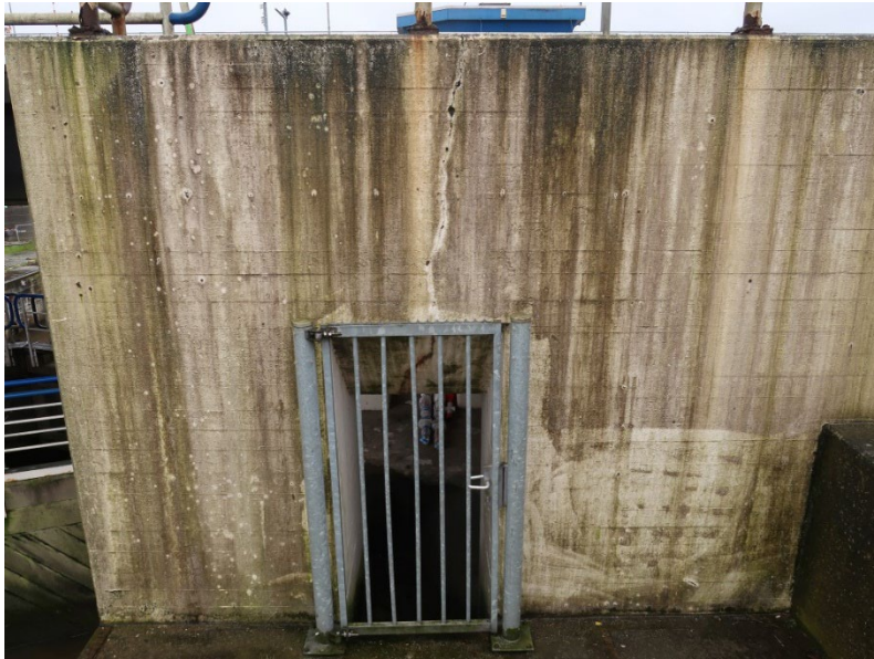
Foto 4: Verticale scheur in het zuidelijke landhoofd
