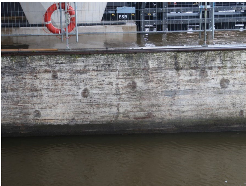
Foto 5: Verticale scheuren in de kolkwand
