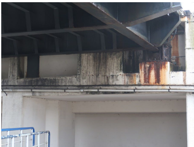
Foto 3: Corrosiesporen onder brugdek
