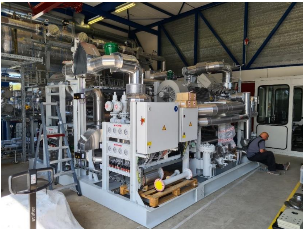
Figuur 1 FUSE warmtepomp geplaatst in het Carnot lab
