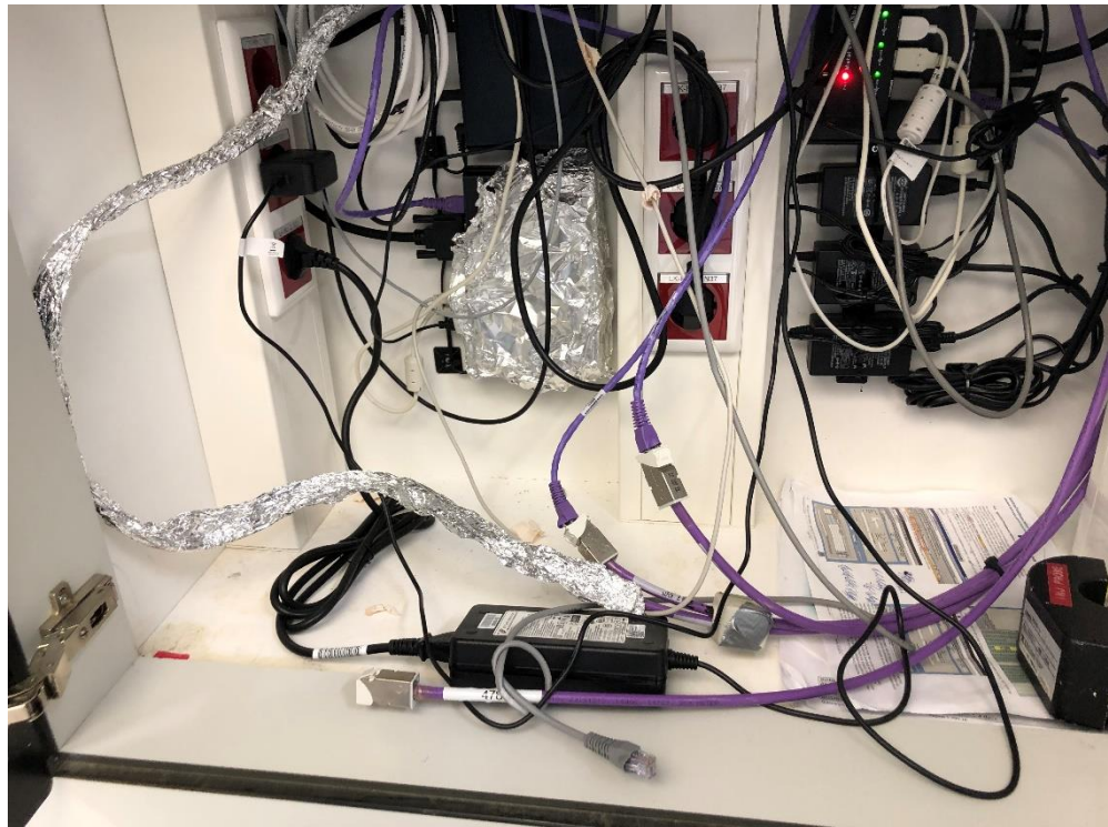
Figuur 10 Ethernet kabel en KVM-switch afgeschermd door een aluminiumfolie.
