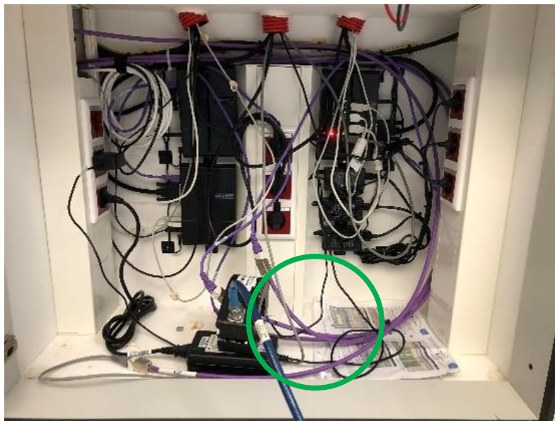
Figuur 9 Metingen van de geleide stroom op een van de ethernetkabels met een stroomklem.
