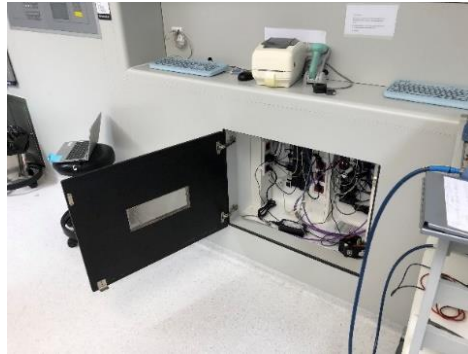
Figuur 3 KVM-switches met voedingen aangesloten aan de monitoren van figuur 2.
