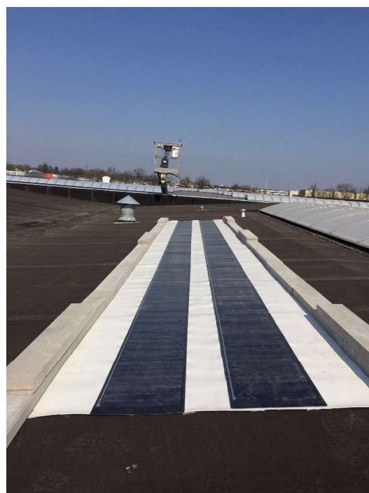
Figuur 3 : geïnstalleerd op dak
