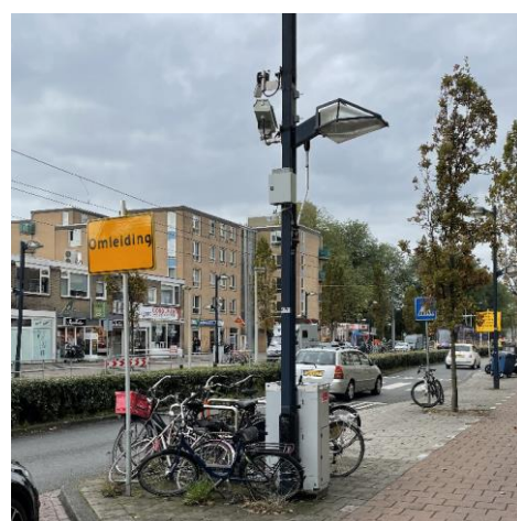
Meetpost rijbaan richting West
