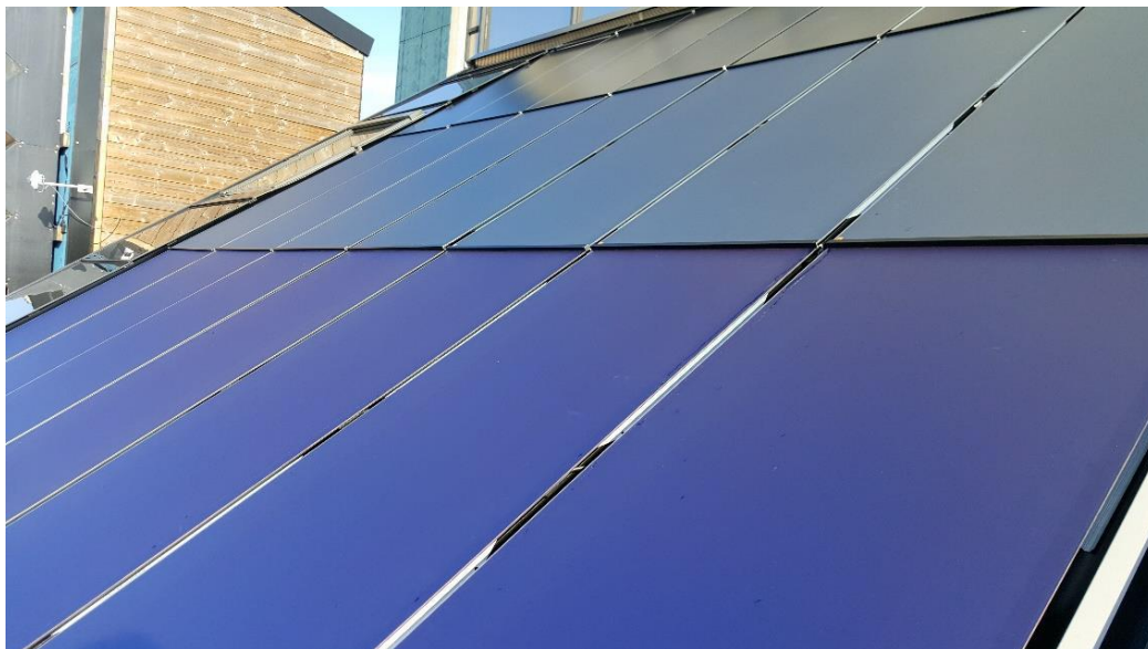
Figuur 3: Rebor schuin dak systeem met gekleurde dunne-film PV modules. Experimentele opstelling op huisje 1 van SolarBEAT.
