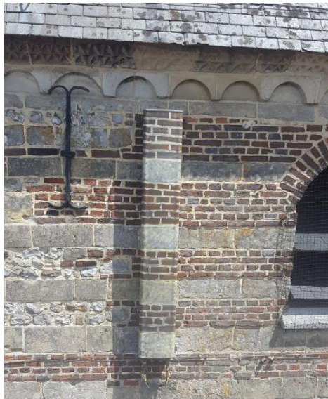
Figuur 7: Voorbeeld van een gecamoufleerde antenne (in casu een sectorantennepaneel) [bron: KWINK Groep 61 ]
