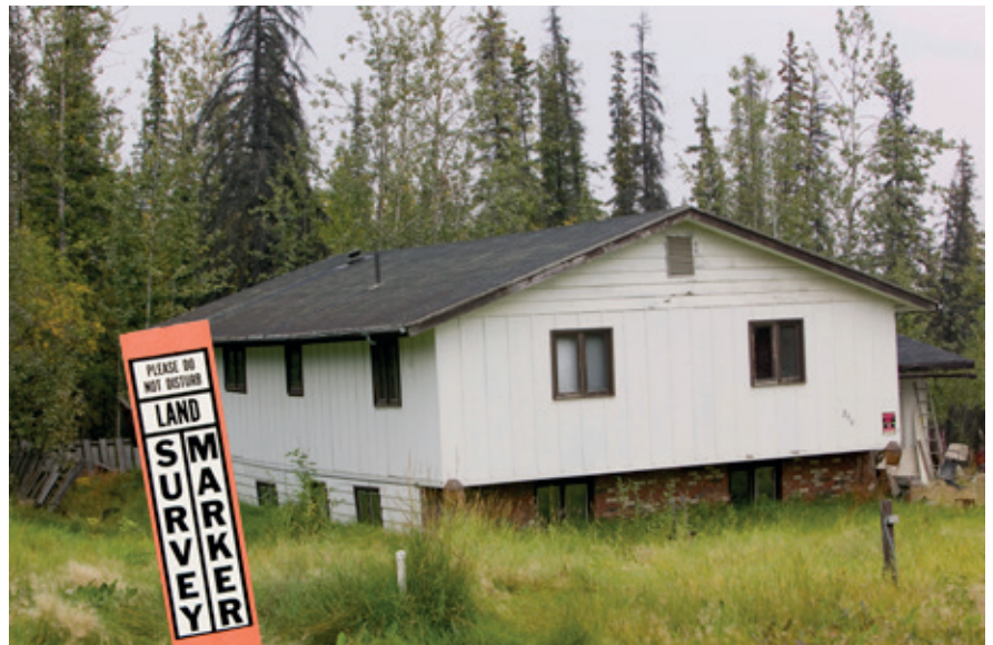
Een huis in Fairbanks Alaska zakt de grond in door het ontdooien van de permafrost als gevolg van de opwarming van de aarde.
