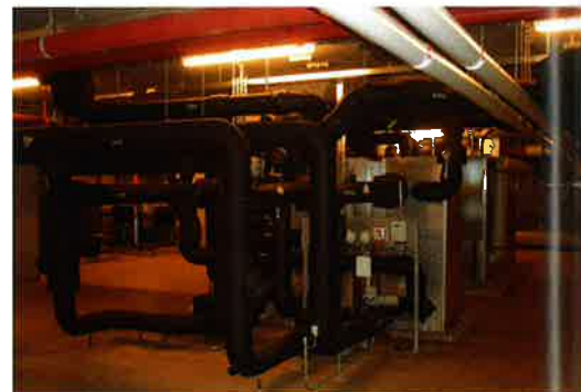
-Figuur 3- Aansluiting Warmte/koude-opslag (WKO) met warmtepomp en cv-verdeler.
