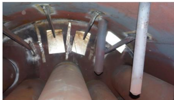
Figuur 14 Voorbeeld van kamsteunen in een ketel
