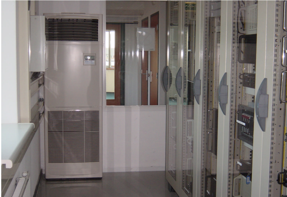
Figuur 3: Server ruimte in een kantoorgebouw. Links achterin staat een luchtbehandelingkast die de koeling verzorgd. Rechts staan de rekken met computerapparatuur. Foto: ECN.
