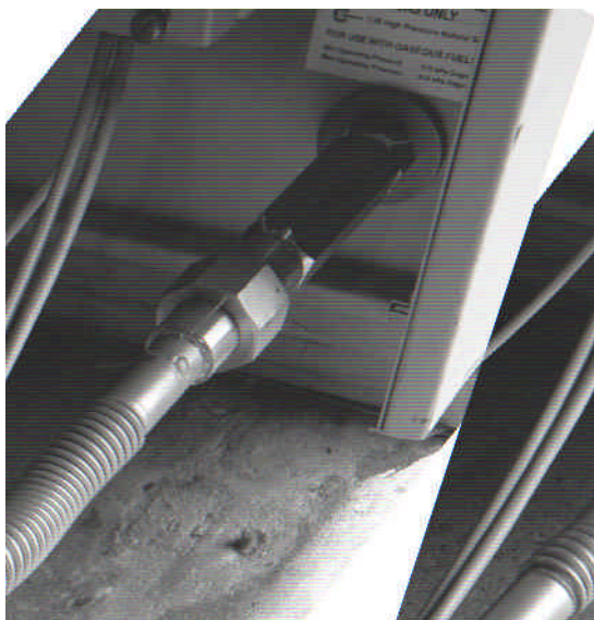
Figuur 2.6 Flexibele aansluiting gasleiding op microgasturbine.
