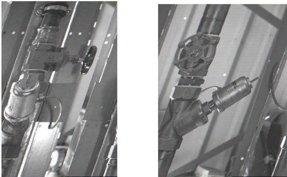
Figuur 2.2 Handafsluiters in leidingen voor aardgas (links) en productgas (rechts). Na de handafsluiters zijn veiligheidssleppen gemonteerd, die sluiten bij gasalarm.
