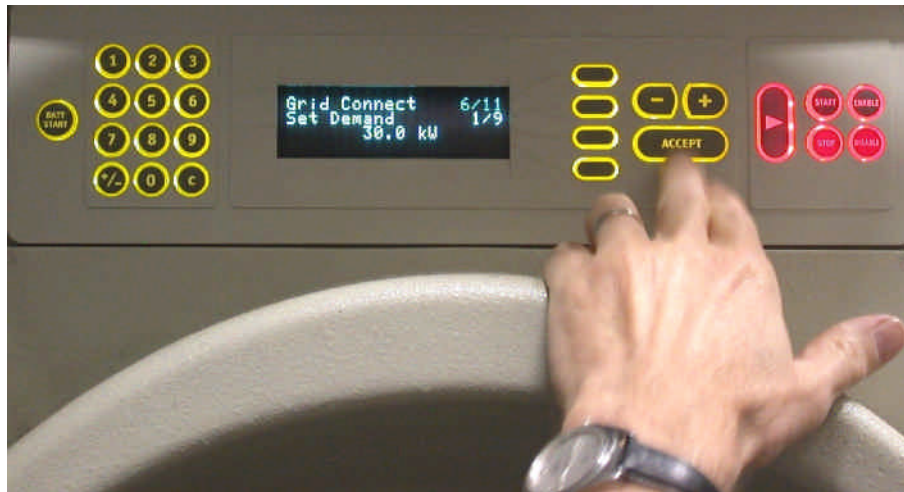
Figuur 2.8 Instellen vermogen microgasturbine via bedieningspaneel.
