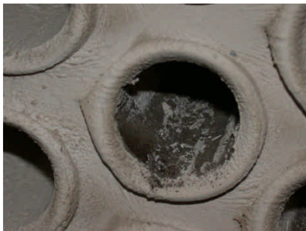
Figuur 8.2 Foto van 1 ketelpijp, met losgemaakte aanslag
