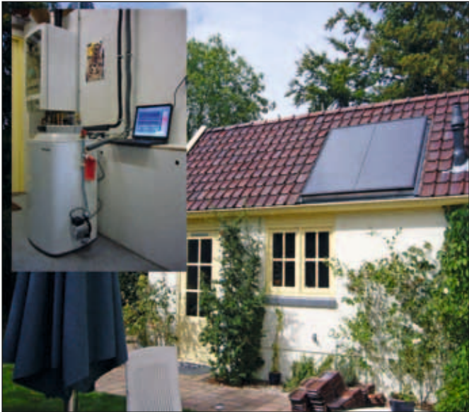
Figuur 11 Testopstelling micro-WKK (HRe-ketel). Bron: GasTerra
