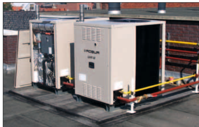
Figuur 18 Voorbeeld van een absorptiewarmtepomp. Bron: BDH
