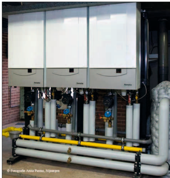
Figuur 6 Drie HR-wandketels in een cascadeopstelling.
