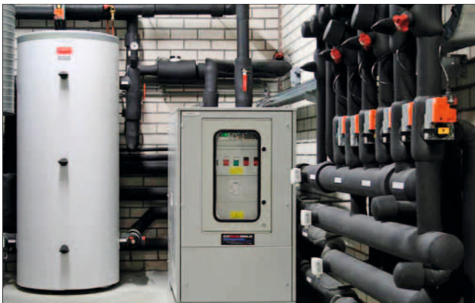
Figuur 18 Technische ruimte met hydromodule. Bron: Gasengineering
