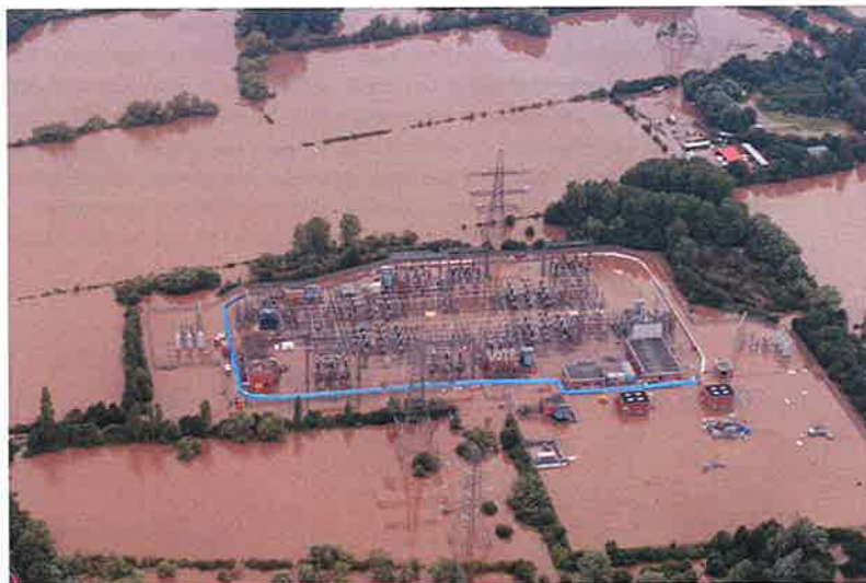
Figuur 3 Walham elektriciteit substation zomer 2007.
