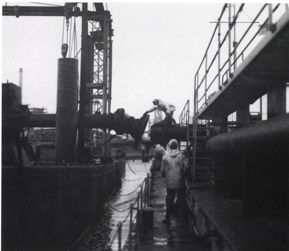
Verontreinigde specie en val- en knelgevaar vormen soms gelijktijdig een bedreiging. Foto: DGA
