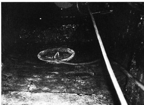
In een put uitmondende afvoerleiding die door middel van een stop is afgesloten.
