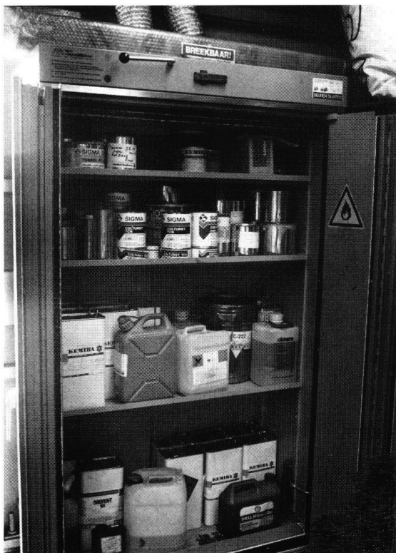
Brandbare vluchtige stoffen worden veilig opgeslagen in een losse chemicaliënkast die voldoet aan NEN 2678.
