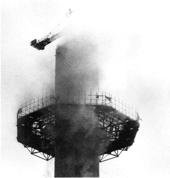
Bekistingsbrand tijdens de bouw van de vluchtleidings-toren op Schiphol. De brand was ontstaan door wegvliegende lasvonken.
