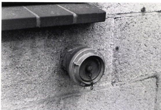
Aansluitpunt voor droge stijgleiding
