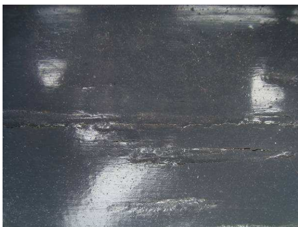
Foto 1. Scheurvorming onderdorpel meetplaats K, meetpunt 2
