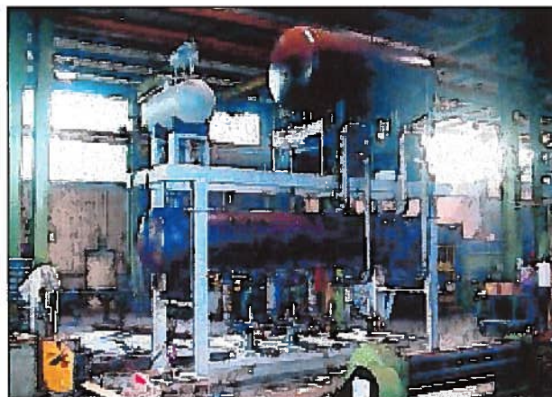
Afbeelding 2: opstelling van het CO 2 vat met pompen en cascadecondensors met afscheider (foto WITT)
