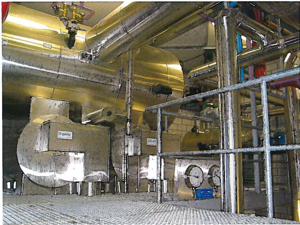
Foto Ammoniakafscheider met daaronder ammoniak/CO 2 cascade condensers.
