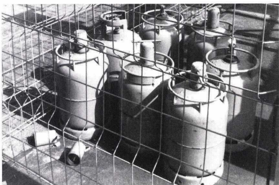
Speciale opslagruimte voor gasflessen
