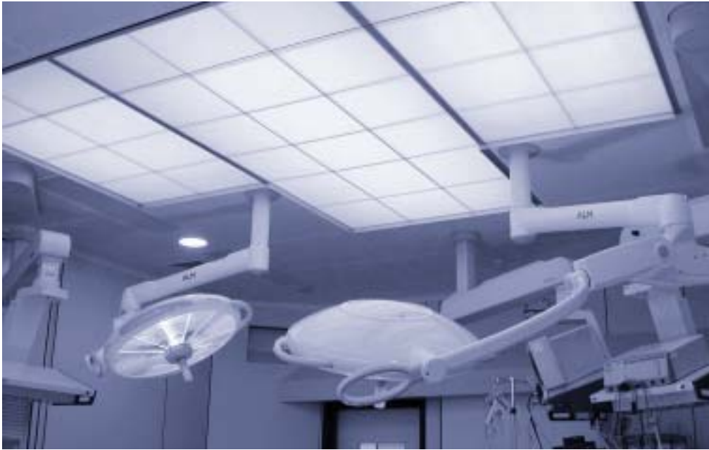
Fig. 7 In twee operatiekamers in dit ziekenhuis zijn plenums geïnstalleerd, waarbij de lucht afhankelijk van de plaats met verschillende temperaturen uitstroomt, afhankelijk van de voorkeur van het operatieteam. De specialist krijgt daarbij de laagste temperatuur, de operatieassistenten een wat hogere en de anesthesist de hoogste temperatuur (21°C). Door deze methode ontstaat een zeer stabiele luchtstroming. Berekeningen vooraf met Computational Fluid Dynamics programma's hebben dit ontwerp ondersteund. Metingen achteraf bevestigden de goede werking van het systeem.
