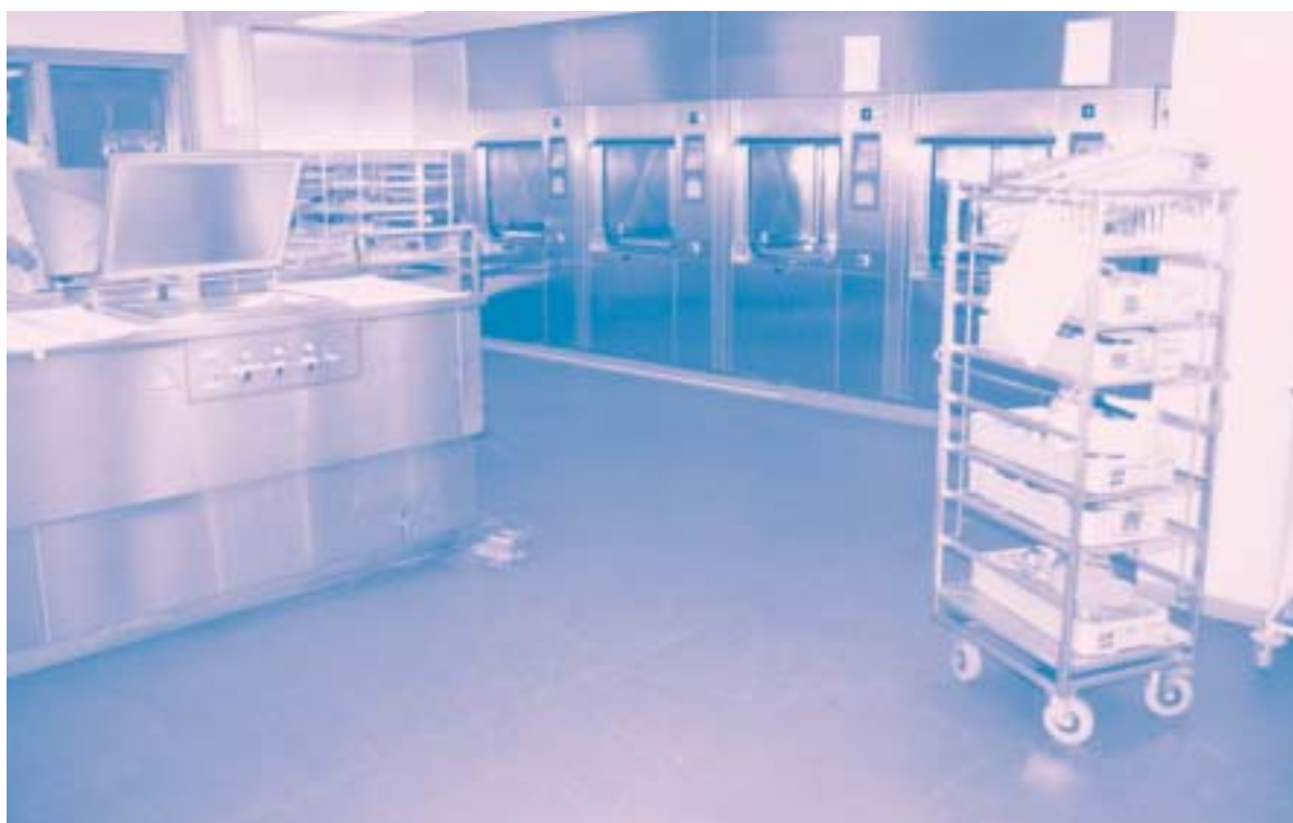
Afb. 3 Reinigingsruimte: de te reinigen materialen worden op een trolley aangevoerd. Aan de linkerzijde de spoelbakken voor handmatige reiniging. In het midden de wand met wasmachines.
