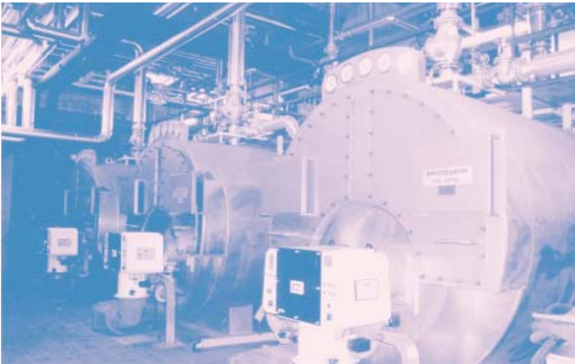
Afb. 7 Technische ruimte met de verwarmingsketels.
