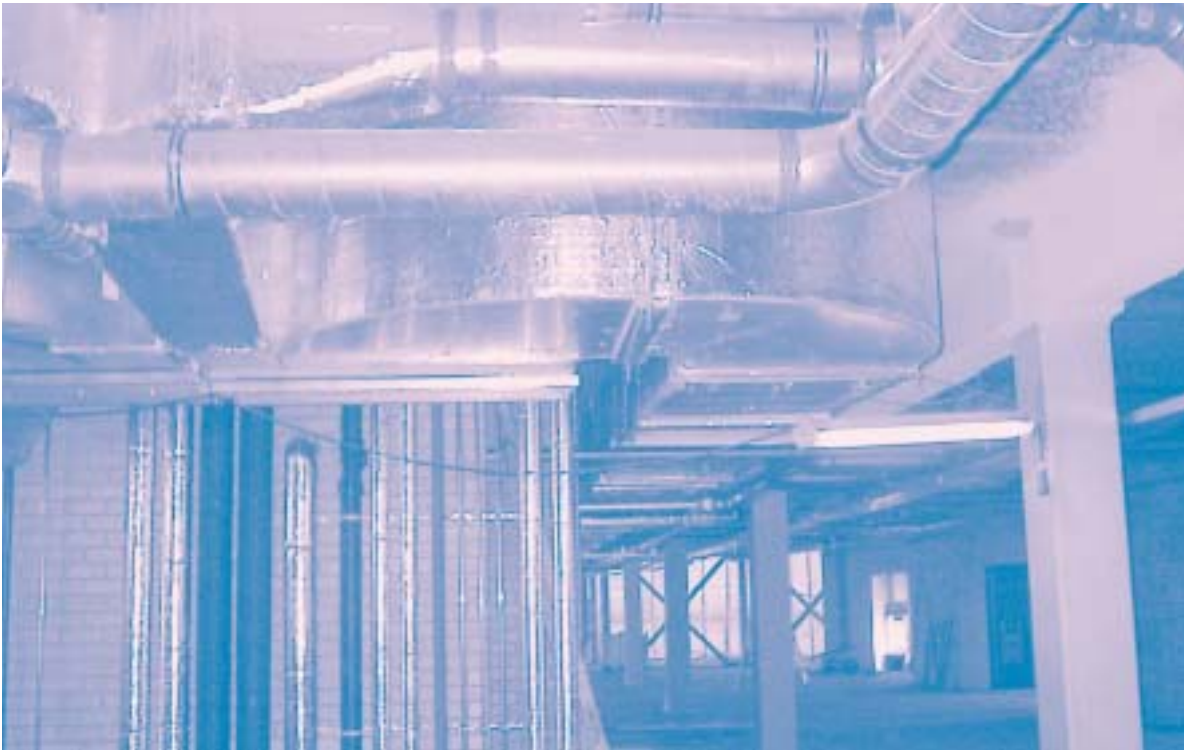
Afb. 4 Kanalen boven het verlaagde plafond die gekoelde lucht toevoeren naar ruimten waar koeling noodzakelijk is.
