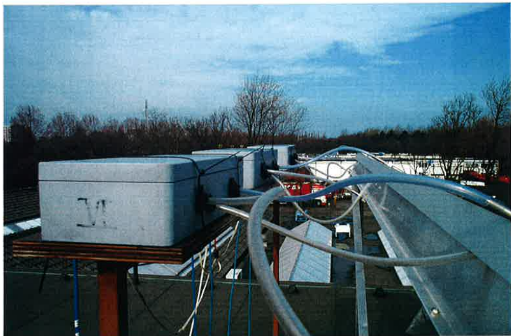
Foto C.5: Detailopname opstelplaats drukmeters bovenzijde
