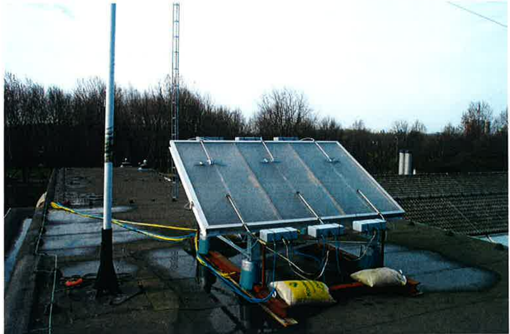
Foto C.1: Collector op het platte dak
