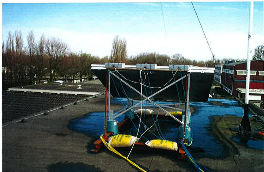
Foto C.2: Collector op het platte dak, zicht op onderkant
