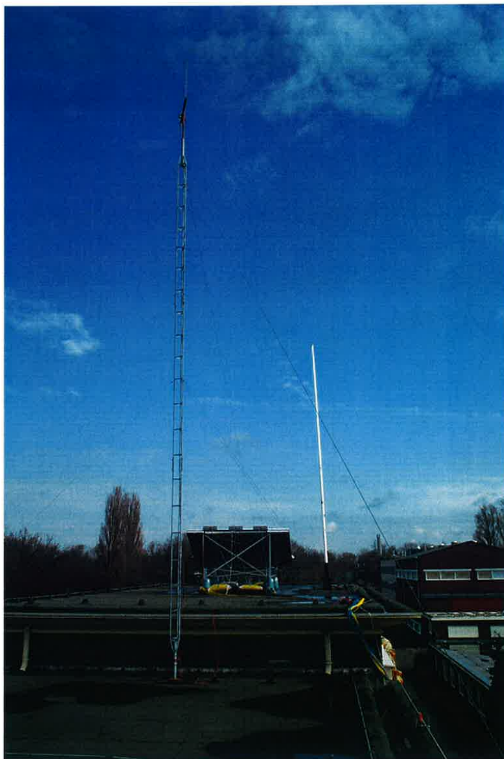
Foto C.3: Overzicht van meetmast en zonnecollector
