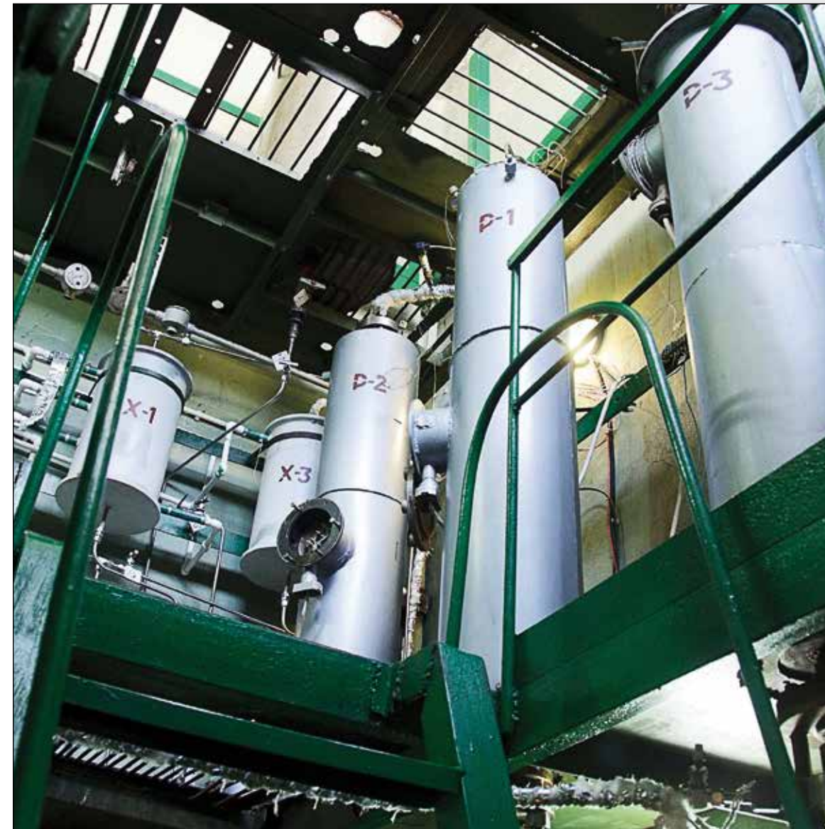
De pilot plant voor gas to liquid in het Russische Elektrogorsk.
