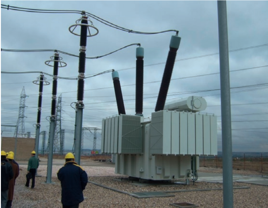
Figuur 7 Procesbesturingssystemen – zoals dit schakelstation voor hoogspanning – zijn cruciaal voor de bedrijfszekerheid.
