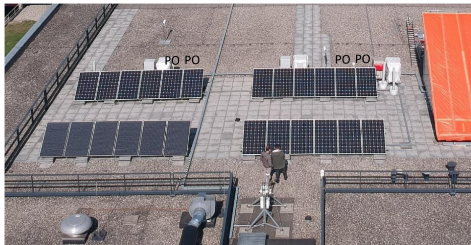
Figuur 2.22. Test faciliteit in TNO-Eindhoven. De achterste 2 rijen zonnepanelen zijn voorzien van 2 power optimizers (links Heliox en rechts GNE), de voorste rechter rij heeft geen power optimizer.
