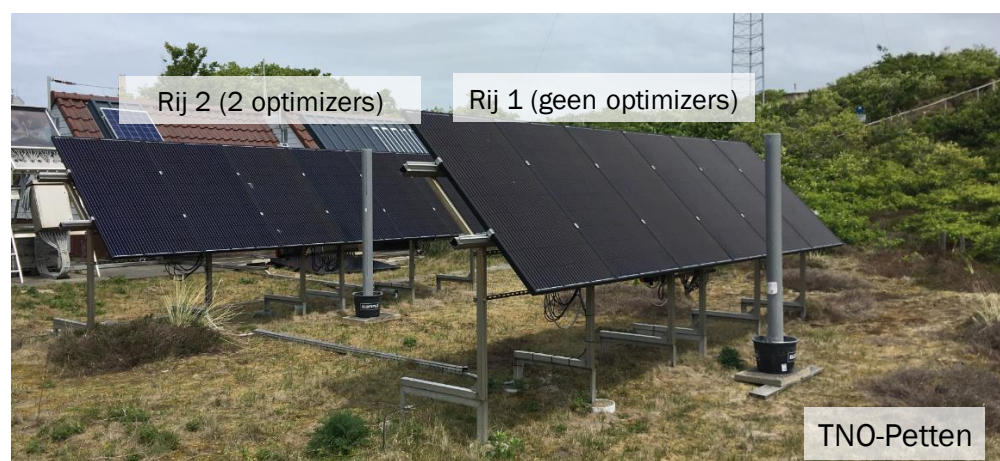
Figuur 2.7. Veldopstelling met paalschaduw, met en zonder power optimizers
