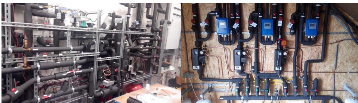
Leidingwerk van de thermische loop in de kelder (links) en in het WenSDak testhuisje (rechts)
