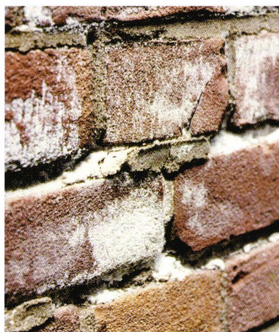
Figuur 17 Als gevolg van zoutkristallisatie op het grensvlak van voeg- en metselmortel wordt de voegmortel uitgedrukt. © TNO Bouw
