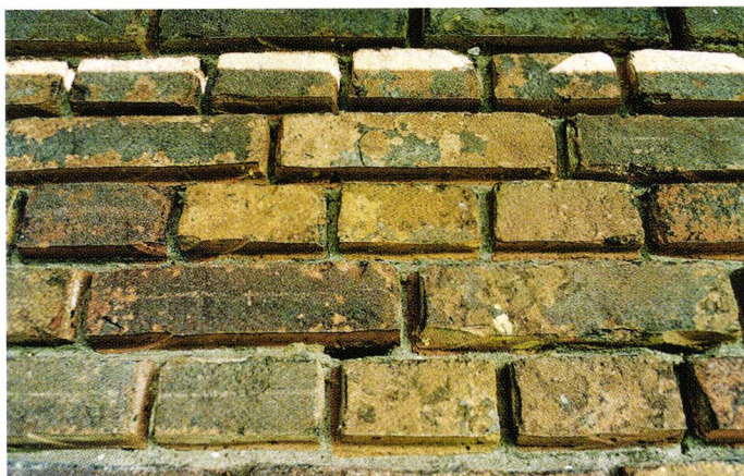
Figuur 46 Schade aan de baksteen door het onvoorzichtig ruimen van de voegen. © TNO Bouw
